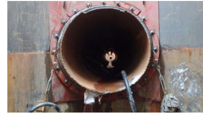
3. 既設管(SP推進管)
