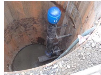
10. 立上げ管(UVガードPE管)
